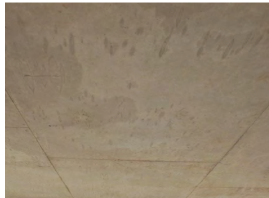
Wellenabdrücke im Beton
