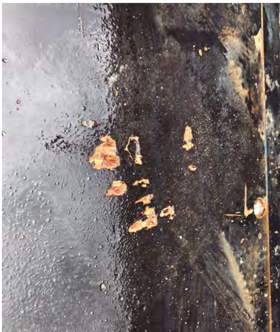
Rüttlerbedingte Schäden auf der Plattenvorderseite
