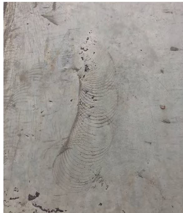
Rüttlerspuren auf dem Beton
