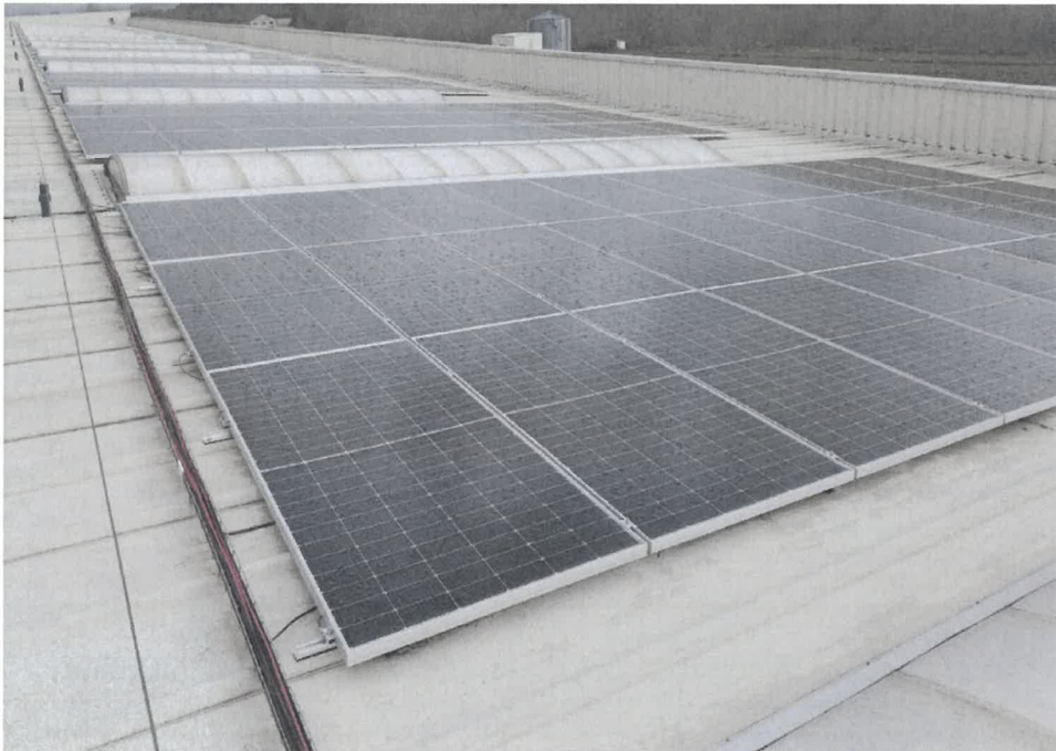
Imagen 3. Placas solares instaladas sobre la fábrica de Baños II para la generación de energía renovable
